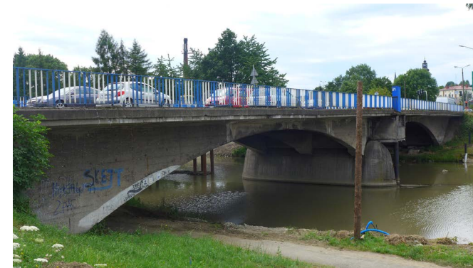
Most na ul. Bielskiej przed remontem
